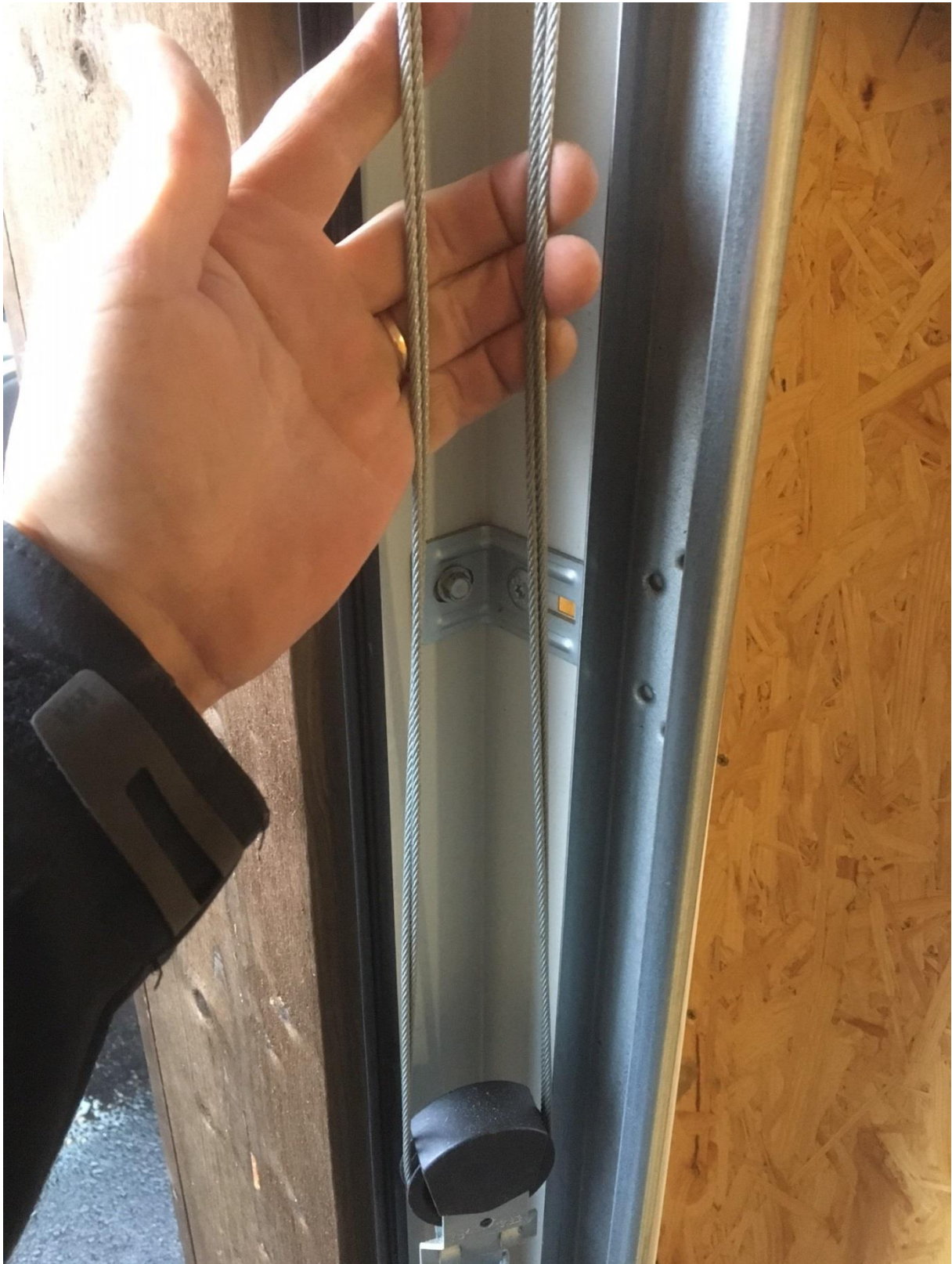
Bild 9 – Rostskyddas med transparent Dinitrol, spraya utan pip på vajern när porten är i öppet läge, även bra om Dinitrol hamnar in i väggvinkel.
